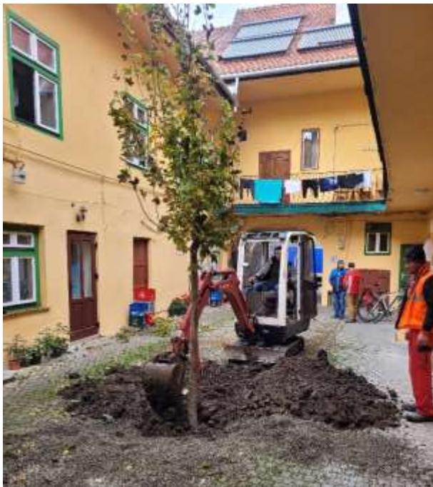
Im Innenhof des Hochmeister-Hauses wird gepflanzt. Das Warmwasser für alle Wohnungen wird durch zwei thermische Solaranlagen bereitgestellt.
